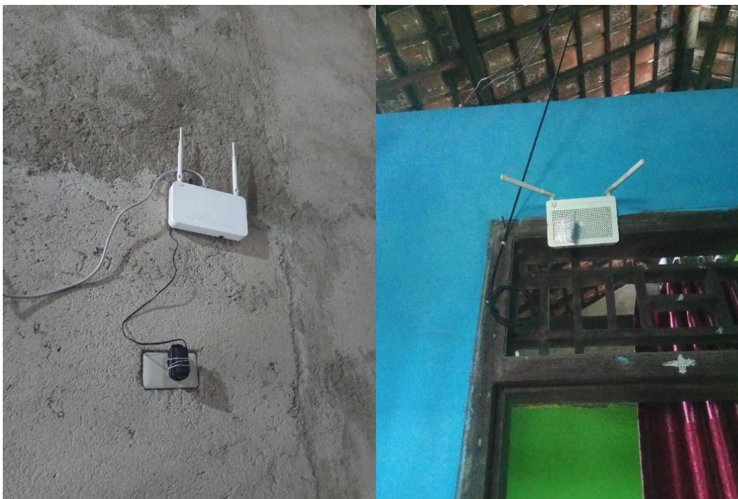
Gambar 1.6 Instalasi Router yang sudah terpasan
