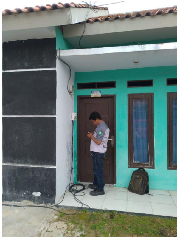
Lampiran 5. Proses Pemasangan KWH Listrik
