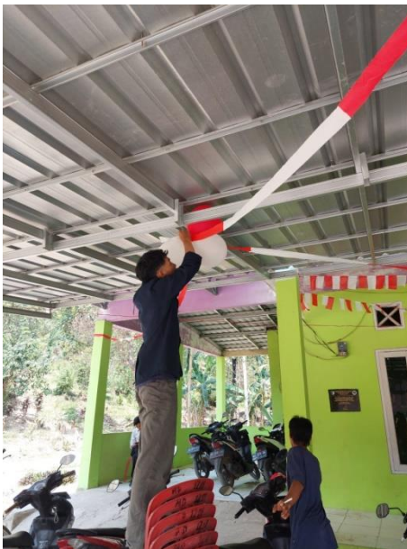
Gambar 3. 2 Membantu Persiapan HUT RI (2) di Balai Desa Mada Jaya
