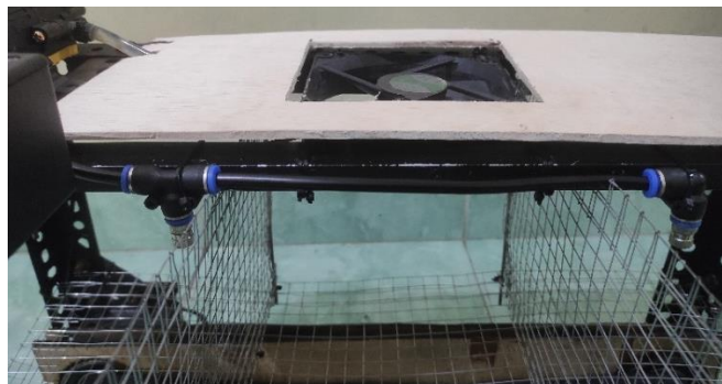
Gambar 4. 6 Fisik Pompa Air Bertekanan
