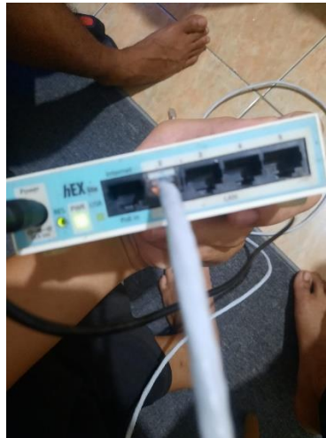
Gambar 4.10 eth2 Mikrotik RouterBoard yang sudah tertancap dan dihubungkan ke Laptop server milik penyusun
