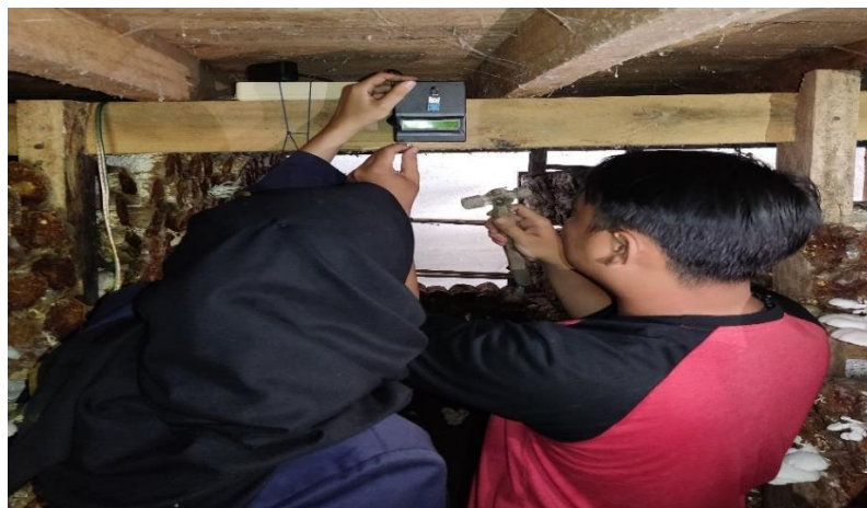
Lampiran 1. 21 Intalasi alat monitoring suhu dan kelembapan
