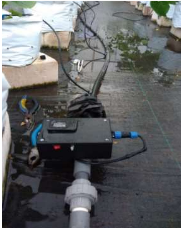
Gambar 4. 4 instalasi Water Flow Sensor Pada Jalur Penyiraman 1
