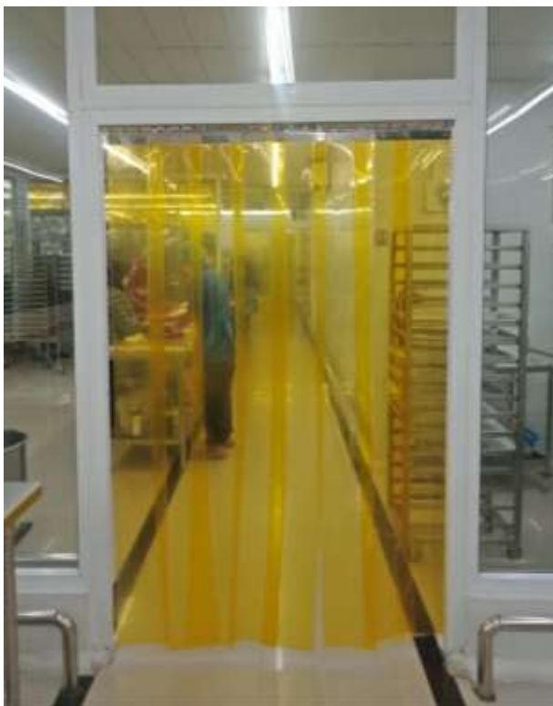
Gambar 9 : Semua akses pintu dilengkapi dengan penutup (Plastic Curtain)
